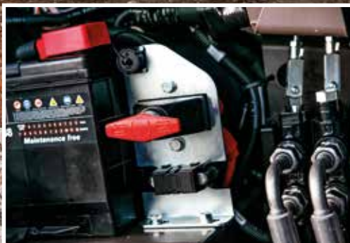
Päävirtakatkaisin helpottaa huoltoja.
